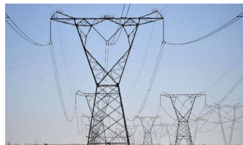
TORRE TRANSMISSÃO DE ENERGIA
